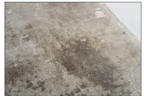
Geigelte Betonoberfläche mit Rissen und ausgebesserten Löchern
