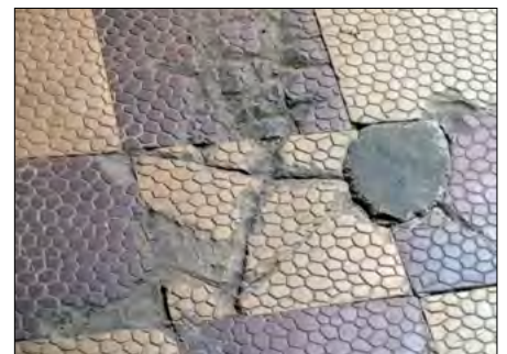
Risse und ausgebesserte Löcher an historischen Zementfliesen
