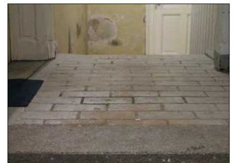
Ziegelboden mit minimal ausgebesserten Schäden – Tapetenwerk Leipzig
