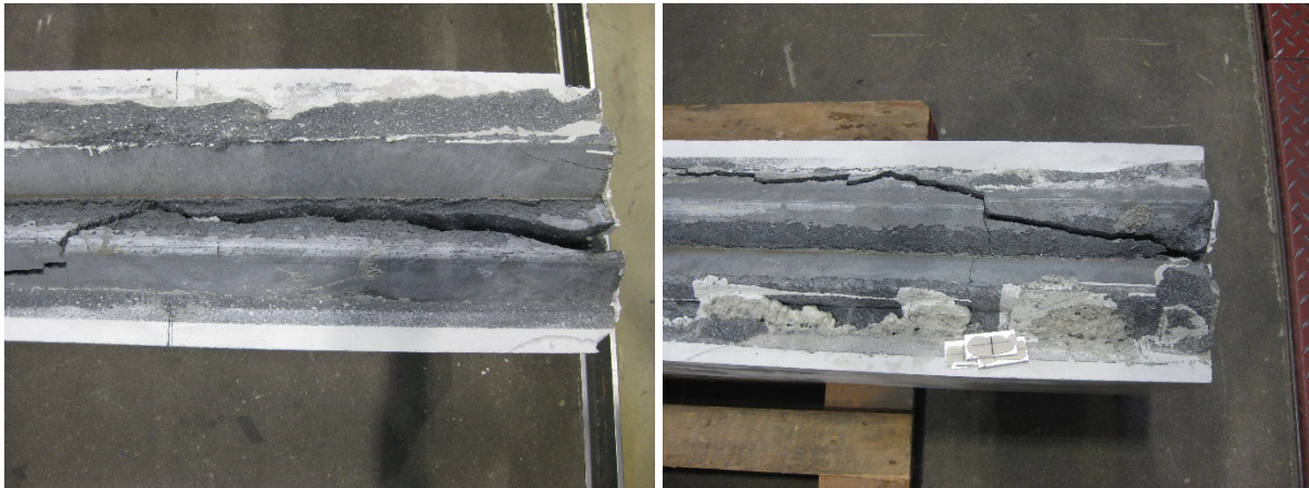
Abbildung 2-16: Versagensrisse im Wandkopf- (links) und Wandfußbereich (rechts).
