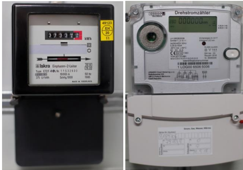
Bild 3: Elektrozähler (links Ferrariszähler, rechts: elektronischer Zähler).
