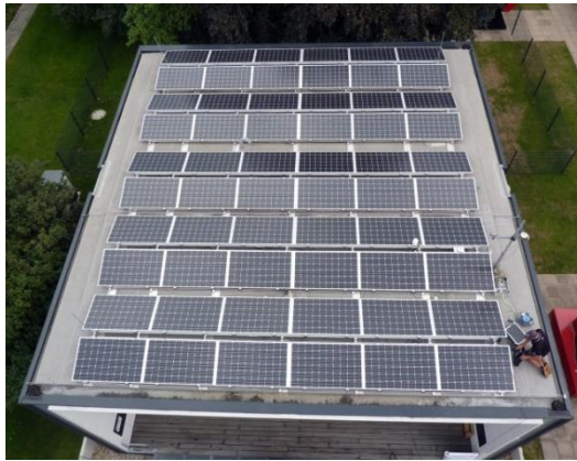
Bild 21: Anordnung der PV-Module als Aufdachlösung am Beispiel des Effizienzhauses Plus in Berlin.
