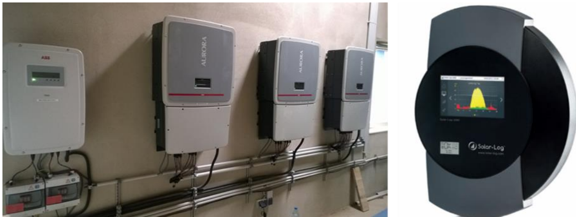
Abbildung 15: Wechselrichter (links) und Solar-Log-Datenlogger (rechts) der PV-Anlage [Quelle: http://shop.wiregate.de/ , abgerufen am 30.03.2015].
