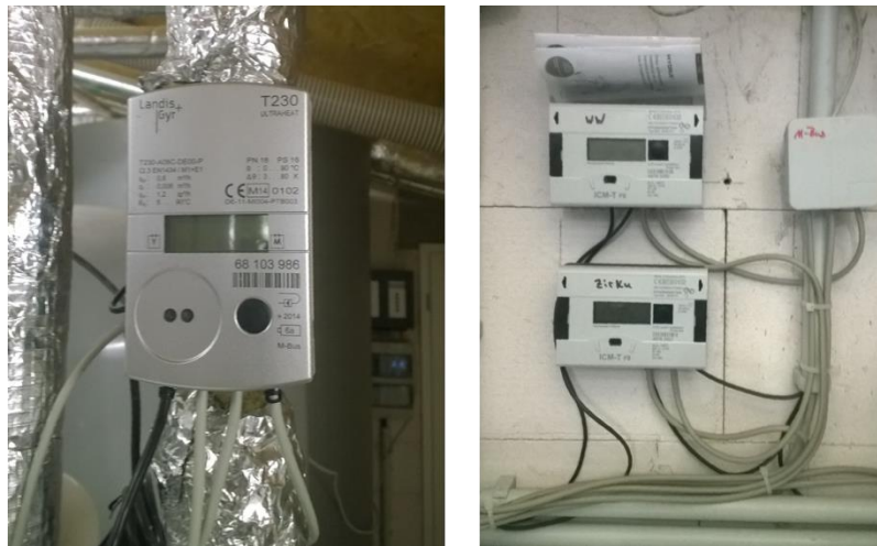
Abbildung 10: Landis+Gyr Wärmemengenzähler zur Ermittlung der gelieferten Wärmemenge der Wärmepumpe (links) sowie Diehl Metering Wärmemengenzähler zur Bestimmung der Energiemengen von Zirkulation und Verbrauch der Warmwasserbereitung (rechts).
