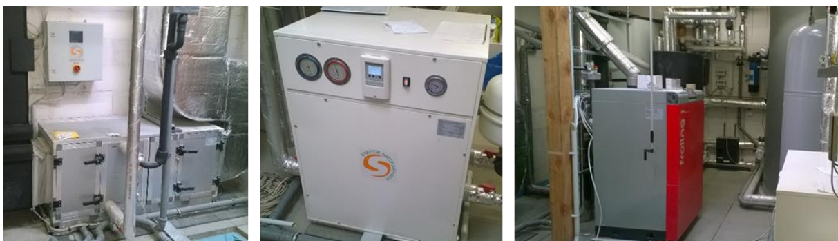
Abbildung 4: Abluftkühlgerät TSAK 1700 mit Regelungseinheit (links), LTS Sole-Wasser-Wärmepumpe (Mitte) und Fröling P4 Pelletkessel (rechts) im Heizungsraum des LVV-Gebäudes.
