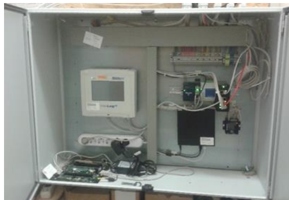
Abbildung 18: Schaltschrank zur zentralen Messdatenerfassung.
