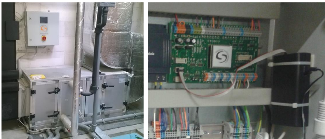
Abbildung 13: Abluftgerät (links unten), Master für die Wohnungslüftung (links oben) und Regelungseinheit mit angeschlossener Programmierschnittstelle für das Monitoring (rechts).
