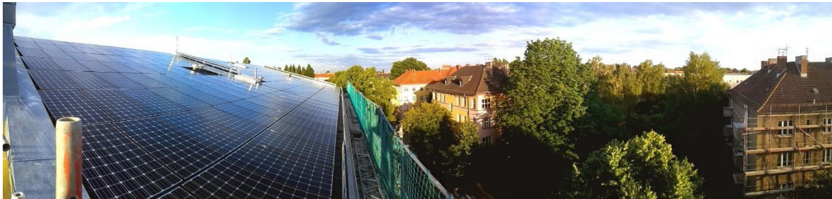
Abbildung 5: Blick auf die Photovoltaikanlage auf dem Dach des LVV-Gebäudes [Quelle: http://la-vidaver.de/ , abgerufen am 01.06.2015].
